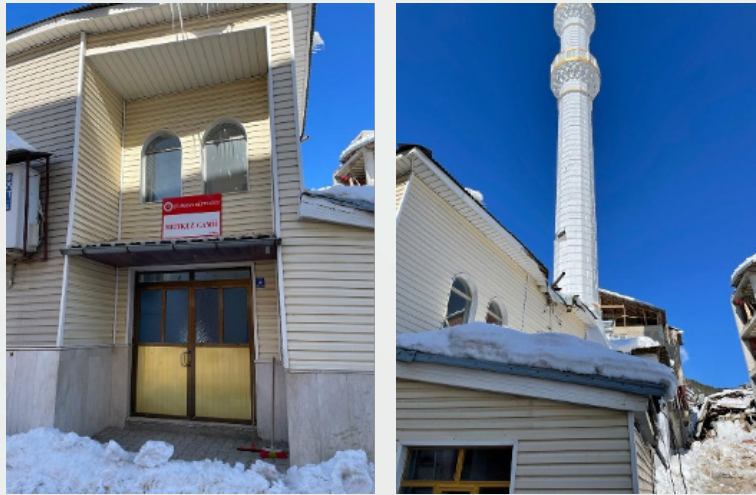
Şekil 3.62. Merkez Cami ve hasarlı minaresi
