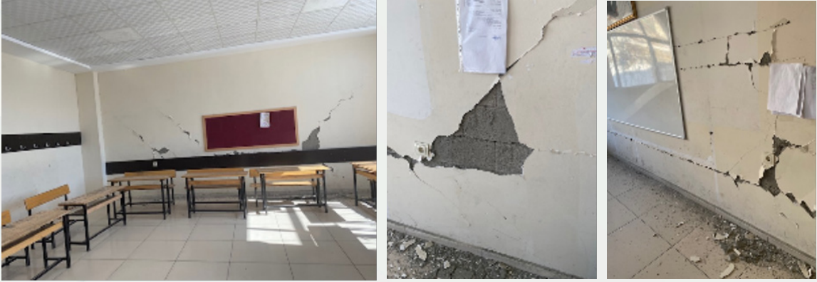
Şekil 3.22. Çelikhan Ortaokulu binası bölme duvarlarında oluşan çatlaklar ve siva dökülmeleri
