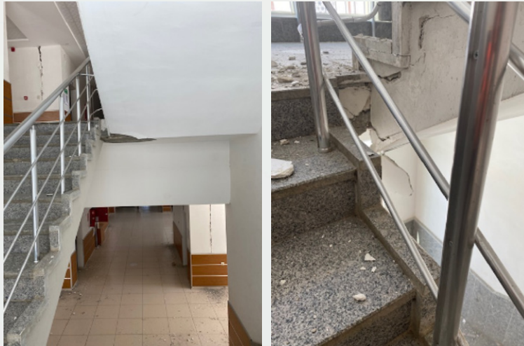
Şekil 3.23. Çelikhan Ortaokulu binası merdiven sisteminde oluşan yapısal hasarlar ve merdiven kaplamalarındaki hasarlar
