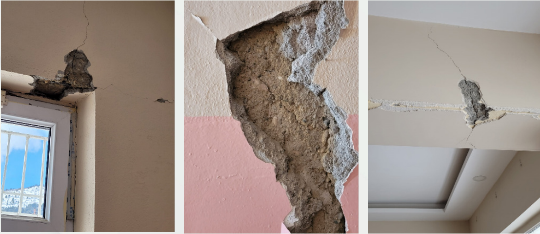
Şekil 3.28. Çelikhan Şehit Seyho Anadolu Lisesi betonarme binasında kiriş ve kolon mesnet bölgesi civarında görülen diyagonal kayma çatlakları
