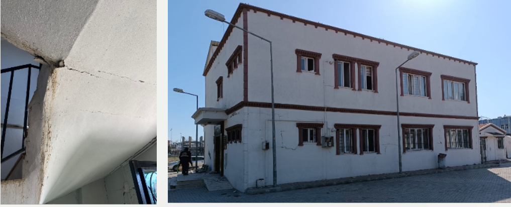
Şekil 3.51. Merdiven hasarı ve duvar hasarı
