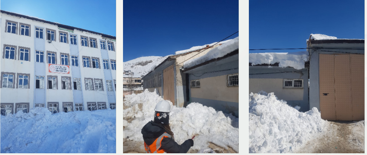
Şekil 3.28. Pınarbaşı Çok Programlı Anadolu Lisesi binası ve kısa kenarlı cephesinde meydana gelen oturma nedeniyle, spor salonu ile arasında ayrılma meydana gelmesi
