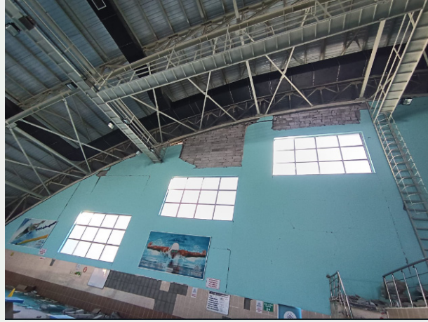
Şekil 3.52. Kalkan duvar hasarı
