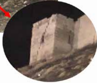
Şekil 3.79. İncelenen tarihi yapılarda gözlenen hasarlar (a)(b) Kiliseler, (c) Şehir kalesi
