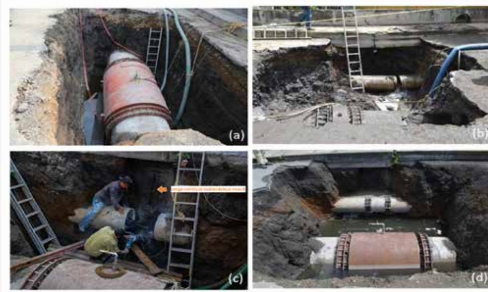
Şekil 5.2.8. Mexico City'deki Colonia Del Mar bölgesinde yaygın olarak görülen boru hattı hasarları ve onarımı (Lemnitzer ve diğ., 2021).
