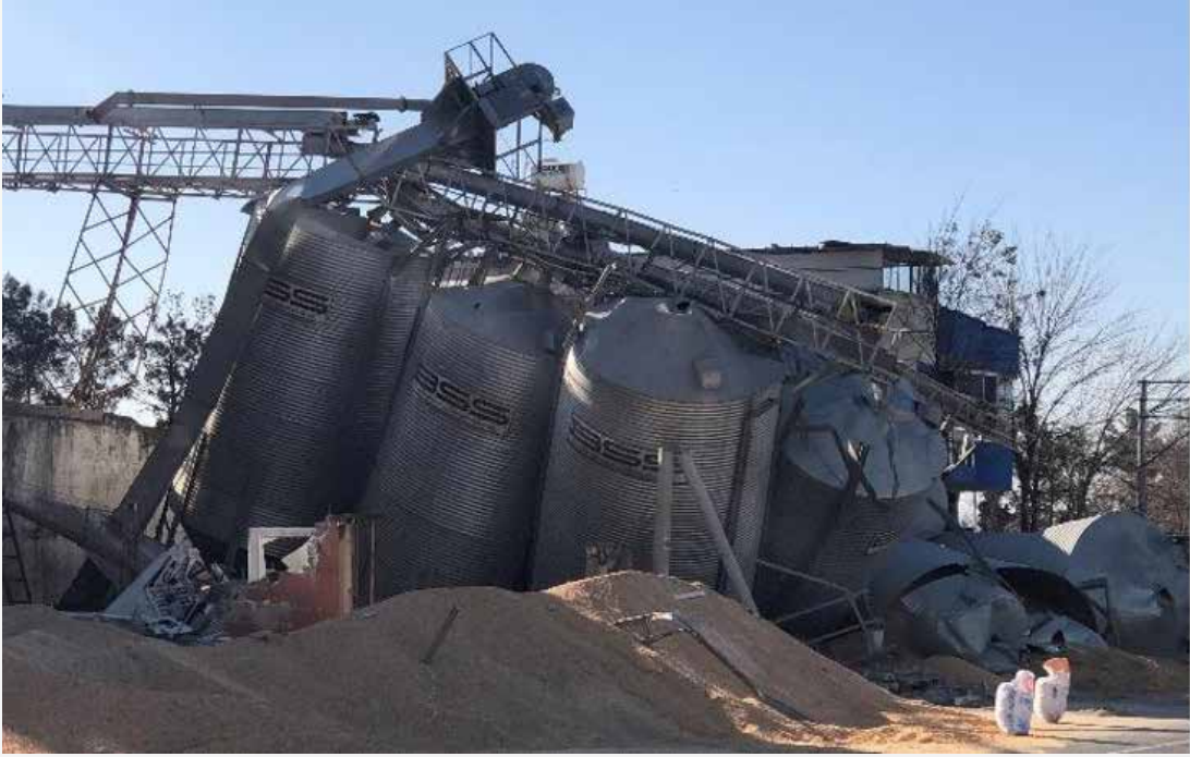
Şekil 3.80. Tahıl silosunda oluşan hasar görünümü
