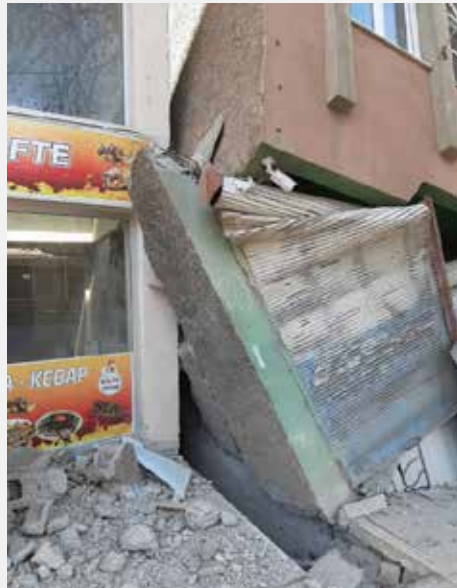
Resim 14. Pazarcık İlçesi D360 karayolu üzerinde bulunan ve tümnden göçme oluşan betonarme bina
