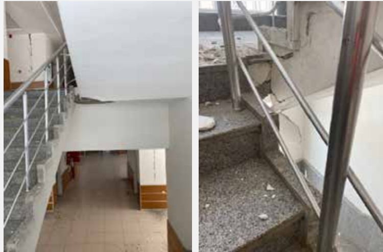
Şekil 3.23. Çelikhán Ortaokulu binası merdiven sisteminde oluşan yapısal hasarlar ve merdiven kaplamalarındaki hasarlar
