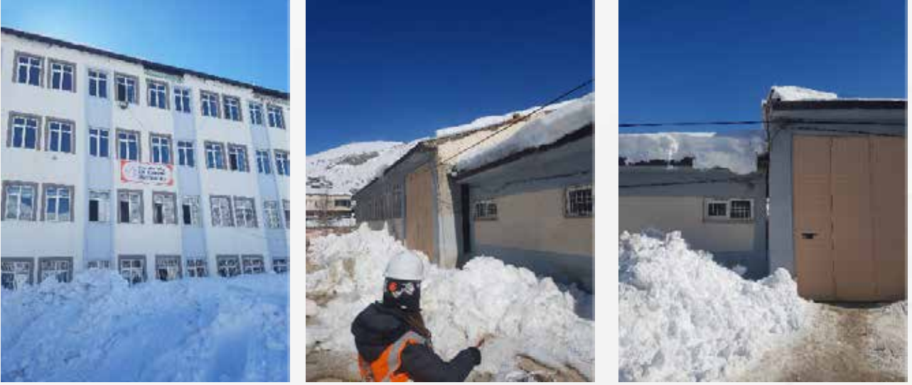
Şekil 3.28. Pınarbaşı Çok Programlı Anadolu Lisesi binası ve kısa kenarlı cephesinde meydana gelen oturma nedeniyle, spor salonu ile arasında ayrılma meydana gelmesi
