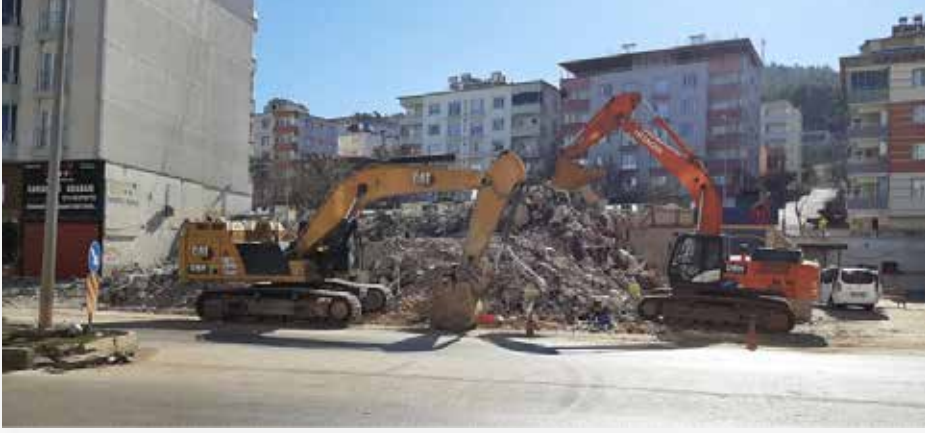
Resim 12. Pazarcık İlçesi D360 karayolu üzerinde bulunan ve tümnden göçen bina
