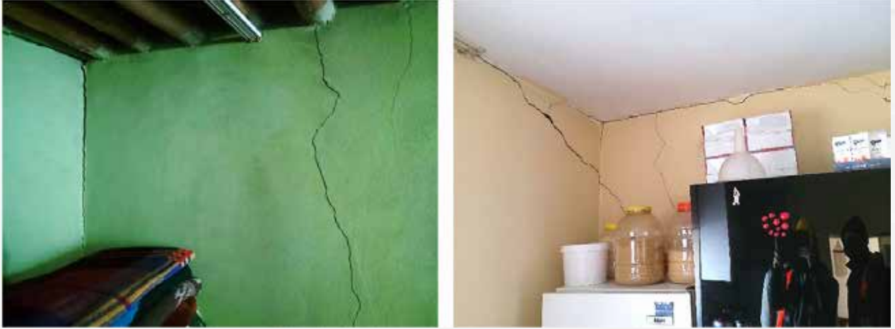
Resim 9. Az sayıda yığma binada rastlanan orta ve ağır hasarlara örnekler.
