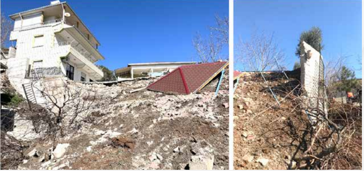
Resim 5. Göçen istinat duvarına ait bazı görseller.
