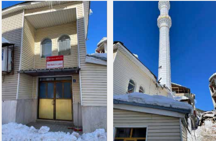
Şekil 3.62. Merkez Cami ve hasarlı minaresi
