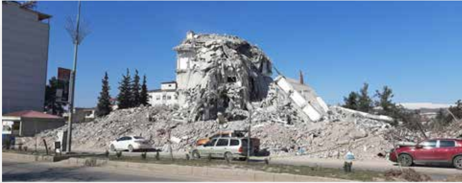
Resim 13. Pazarcık İlçesi D360 karayolu üzerinde bulunan enkaz halindeki betonarme bina
