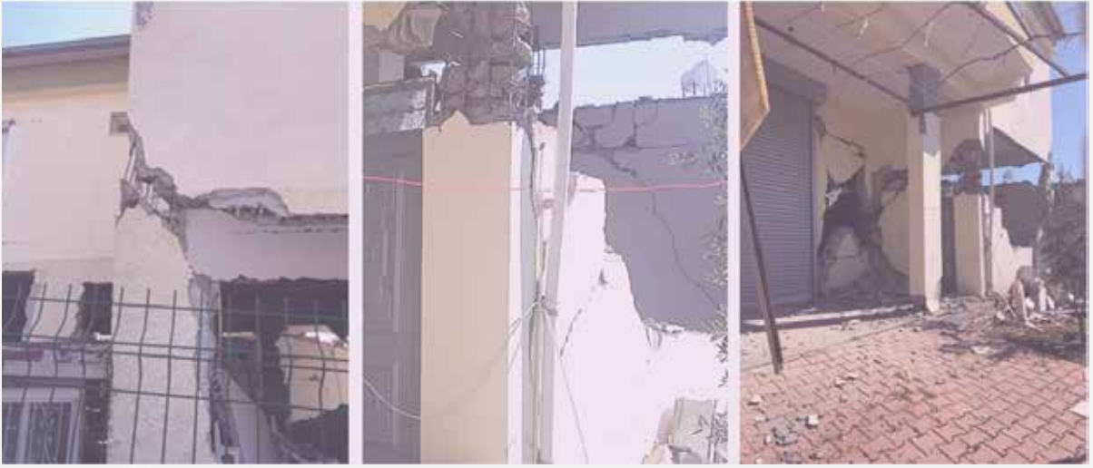
Resim 3. Tümden göçmenin oluşmadığı ancak ağır kolon hasarı meydana gelen bir yapıya örnek.
