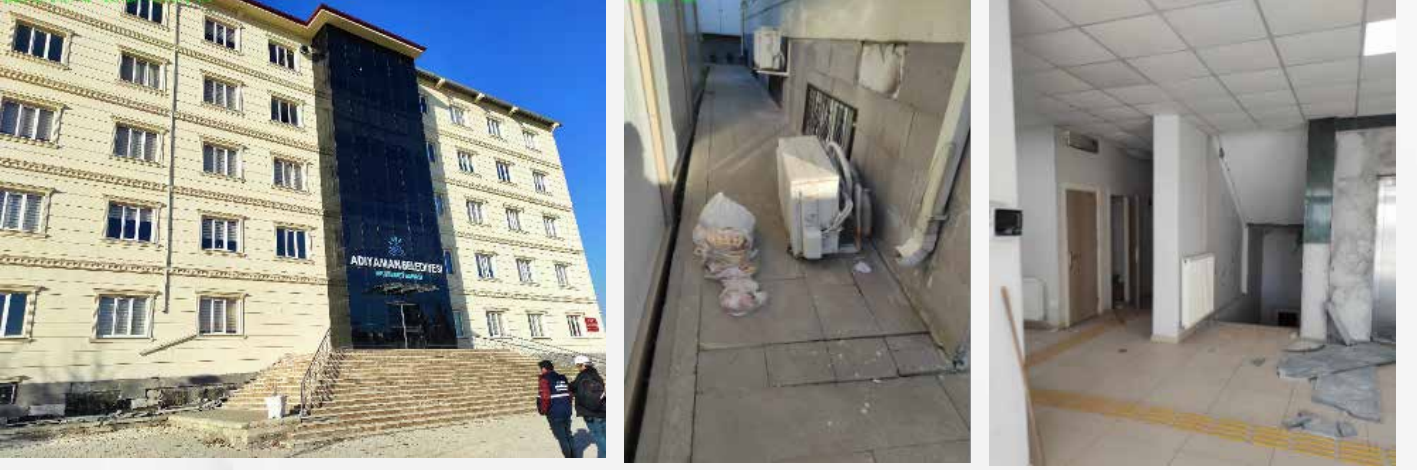
Şekil 3.54. Ek Bina ve zeminde oturma, merdiven hasarı
