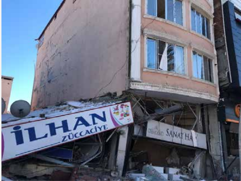
Resim 20. Yumuşak kat düzensizliği nedeniyle oluşan yapısal hasar
