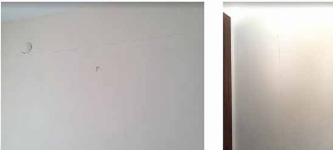
Resim 8. Betonarme binalarda duvar hasarlarına örnek.
