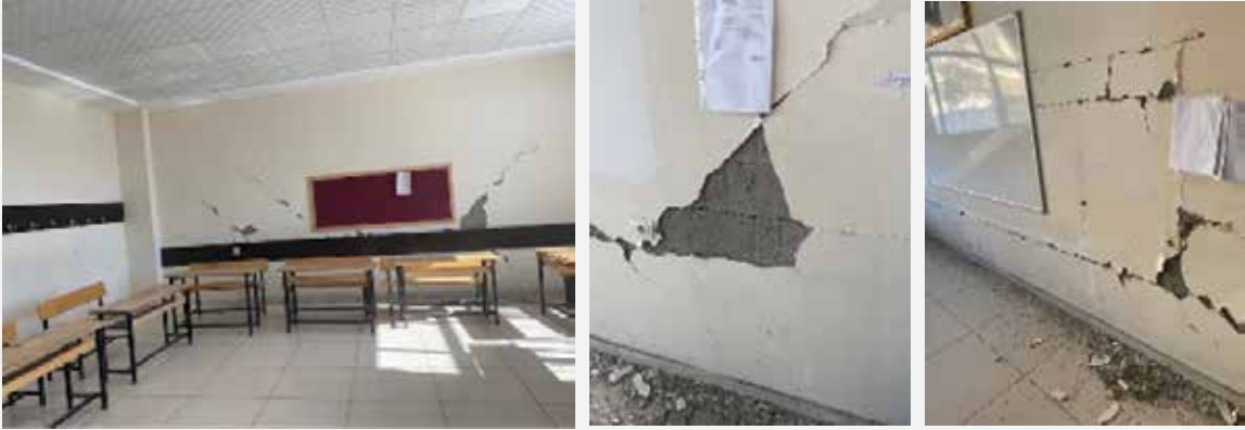
Şekil 3.22. Çelikhán Ortaokulu binası bölme duvarlarında oluşan çatlaklar ve sıva dökülmeleri
