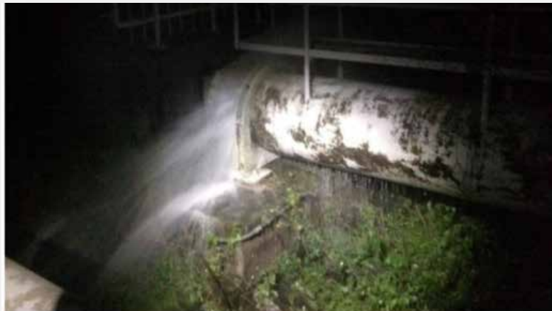
Şekil 5.2.7. Kumamoto Depremi sırasında 800 mm çaplı bir borunun birleşim noktasında meydana gelen sızıntı (Wham ve diğ., 2017).
